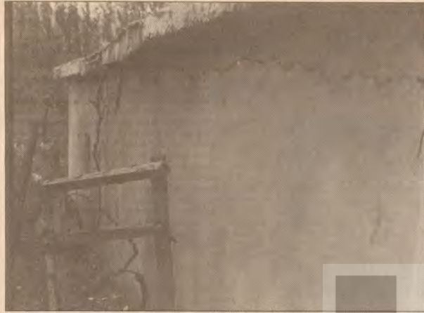
En sağlam evlerde boydan boya böylesi çatlaklar var.
