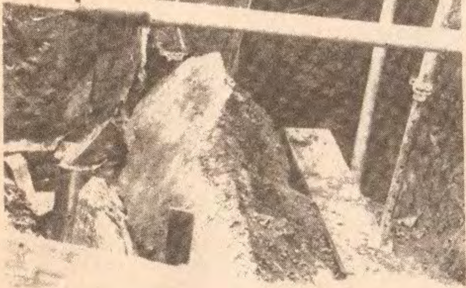
Bu beton ve toprak yığınının altında Türkiyeli yapı emekçisi Selahattin Şahin yatıyor
