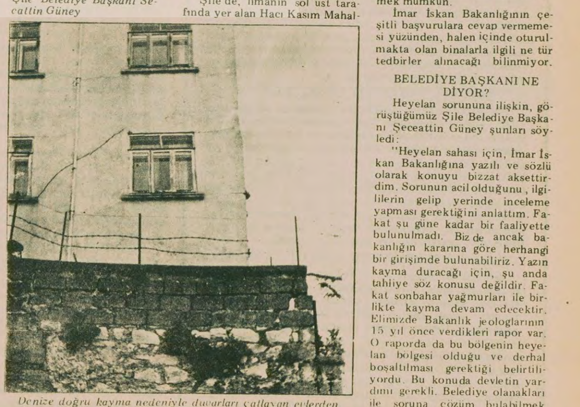
Denize doğru kayma nedeniyle duvarları çatlak olan evlerden biri.
