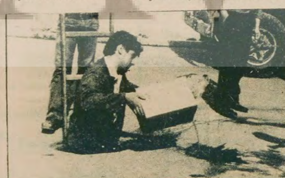
Ek kablo bağlantısı için menhole giren tesisatçının ilk işi çoğu zaman menhole dolan su ve lağım sızıntılarını boşaltmaktır. Çoğunlukla su pompası bulunmadığından bu iş teneke kovalarla yapılır.
