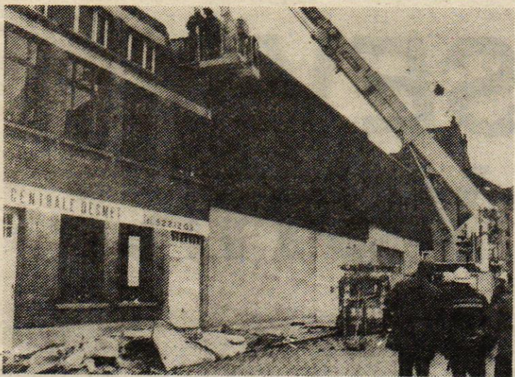
Deux blessés graves à Molenbeek. Un achafaudage dressé sur un immeuble de la rue Vanderdussen, à Molenbeek, s'est effondré hier, entraînant dans sa chute les deux ouvriers occupés à la réparation du toit. Ils ont été grièvement blessés.
