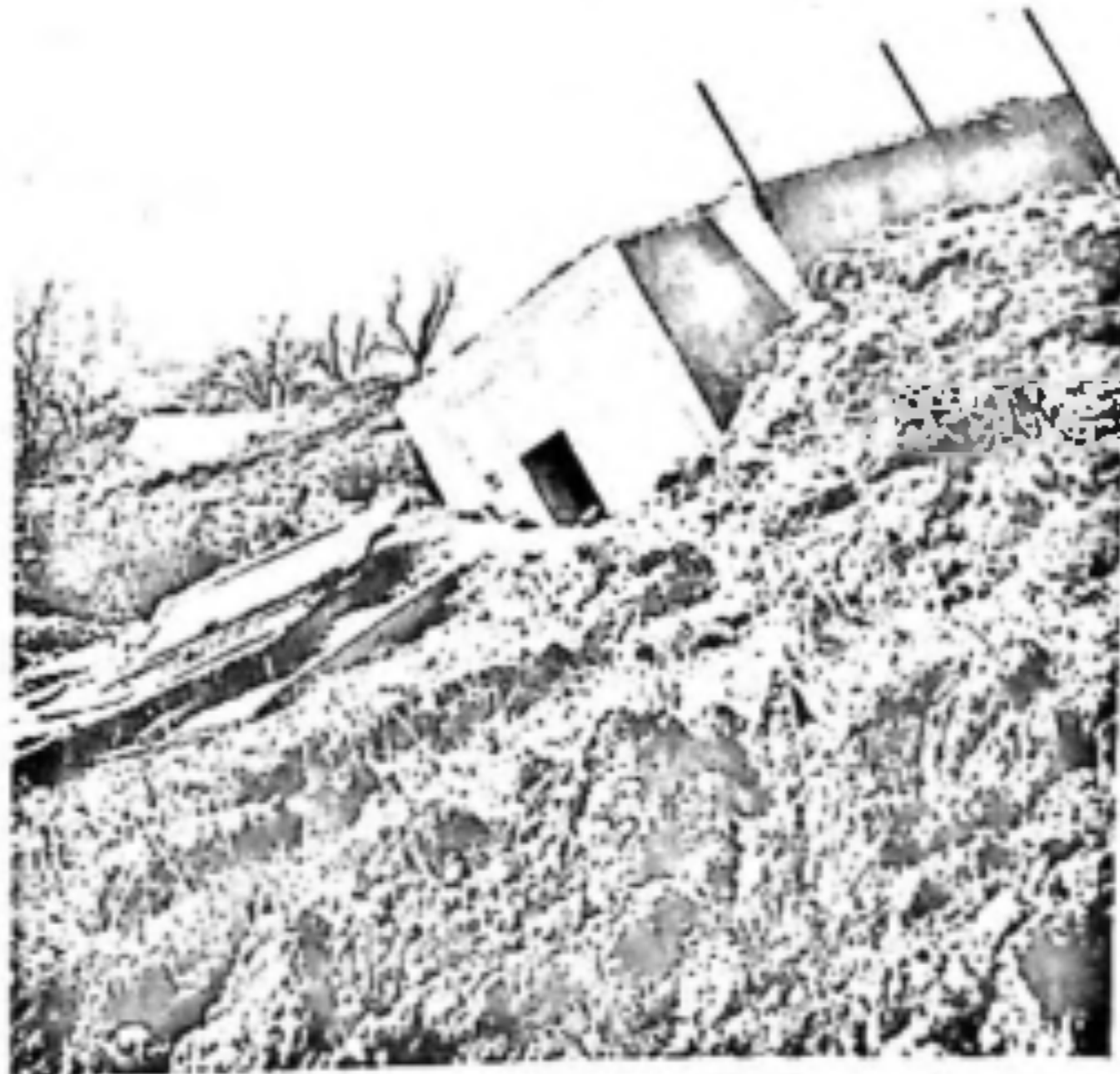
«Eine Katastrophe». Selbst ein Betonbunker konnte dem Erdbeben nicht standhalten. Foto Otto Wyss-Dierks
