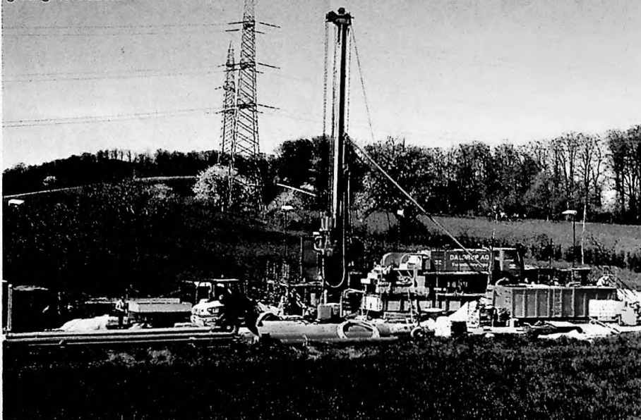
Im Gebiet Zinggibrunn wird zurzeit eine Tiefenbohrung für die dauerhafte Messung des Salzgehalts im Grundwasser vorgenommen. Die Sicherheit wird auch im Bohrgebiet Muttenz gross geschrieben.
