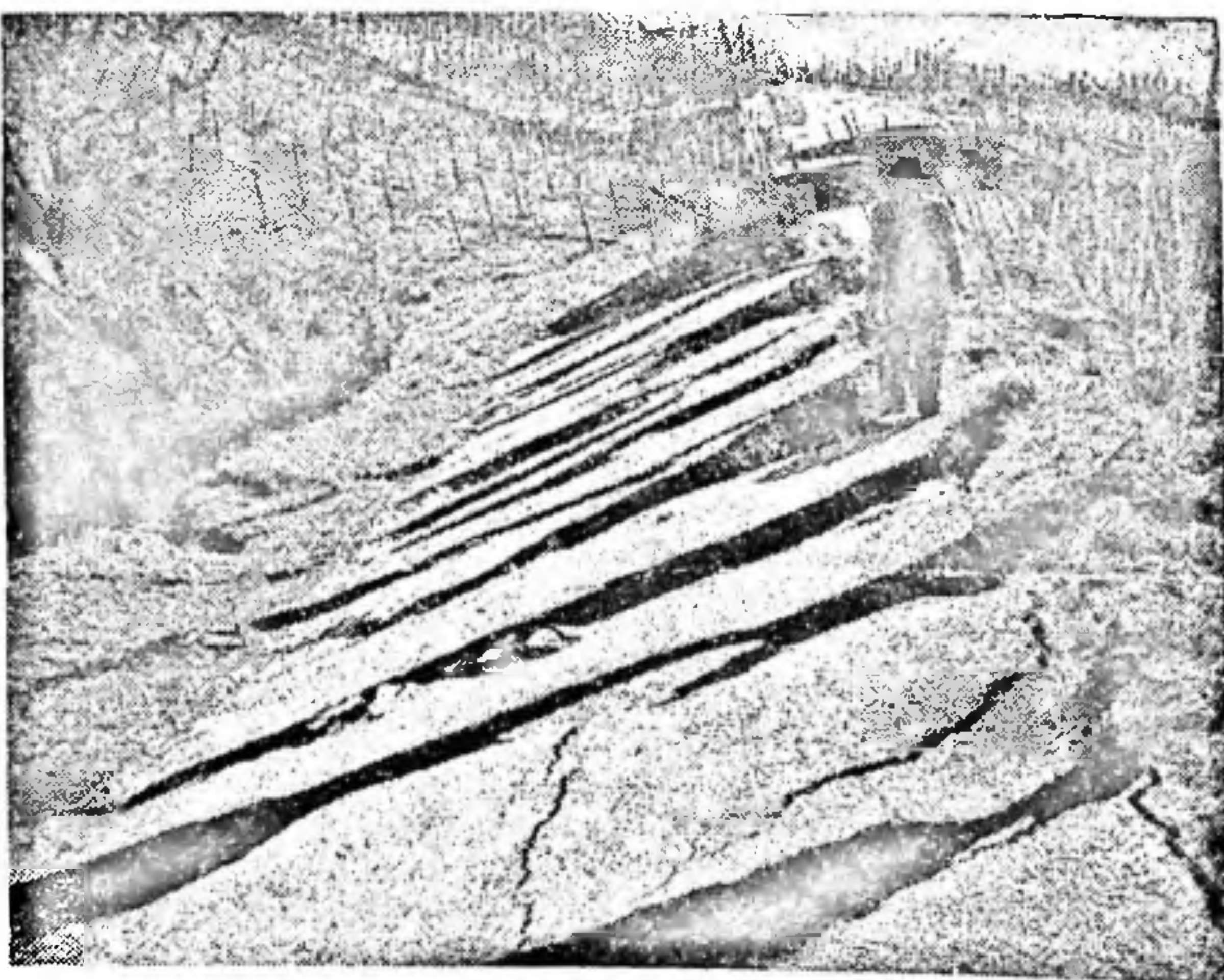
Mit dem Rebberg rutschen die Straßen in die Tiefe, und klaffende Spalten ziehen sich durch den Asphaltbelag, der erst noch eben war und ein gemächliches Wandern durch die Reben erlaubte.
