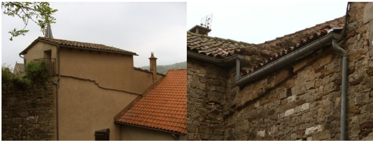
Vestiges du chemin de ronde – Décrochages de dalles du sol
