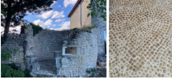
moitié détruite et son sol en pisée
